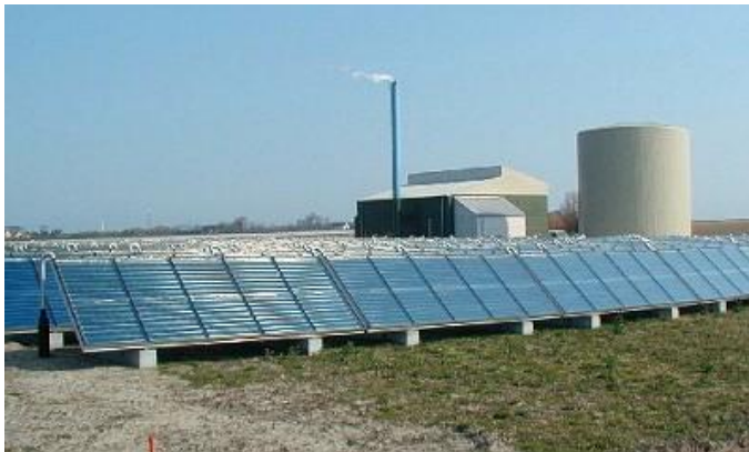
Nordby 2 500 m 2 / 1,8 MW
