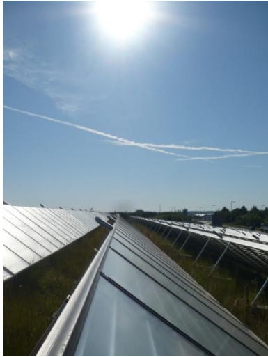
Hillerød 3 000 m 2 / 2,1 MW
